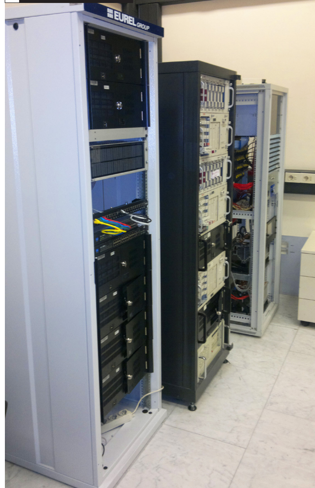
i Rack del Sistema
